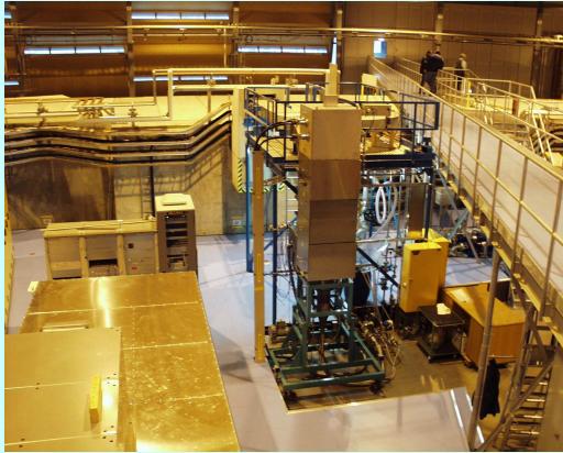
60KW Booster Amplifier (500MHz)
